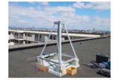
設置済みのGNSS連続観測点（高津区）
