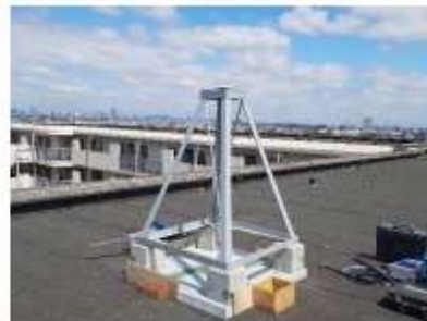
設置済みのGNSS連続観測点(高津区)
